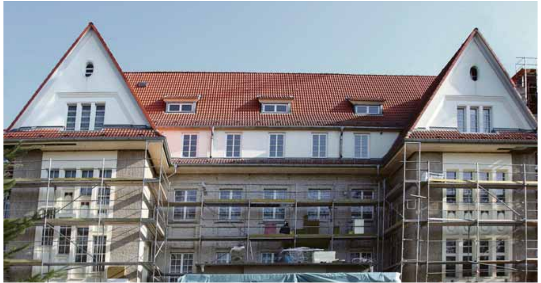
Das stark gegliederte Dach des Krankenhauses ist mit Neigungen von 50 bis 70 Grad konstruiert. Die Fassade wird im Jahre 2010 vollständig energetisch saniert sein.
