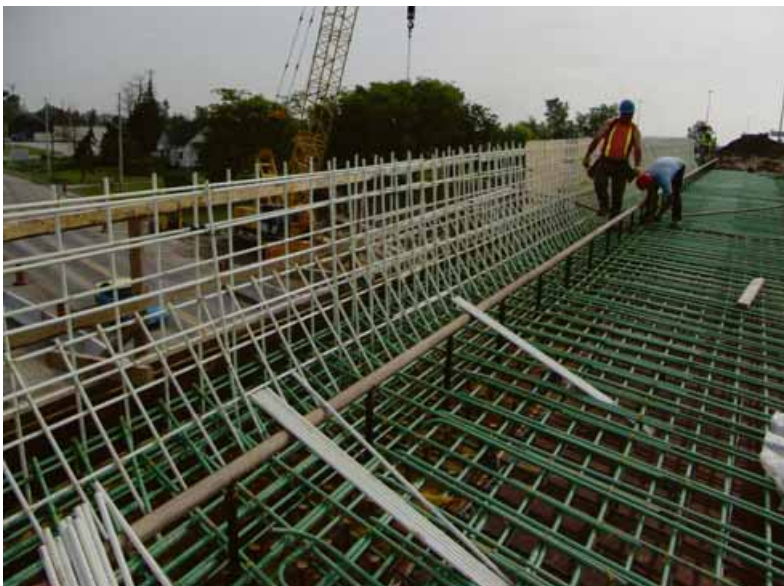
Brückenbau mit Schöck ComBAR: Die enorme Zugfestigkeit bei reduziertem Gewicht ermöglicht auch architektonisch anspruchsvolle Bauwerke. Zudem bietet die glasfaserverstärkte Kunststoffbewehrung Schutz vor Korrosion.
