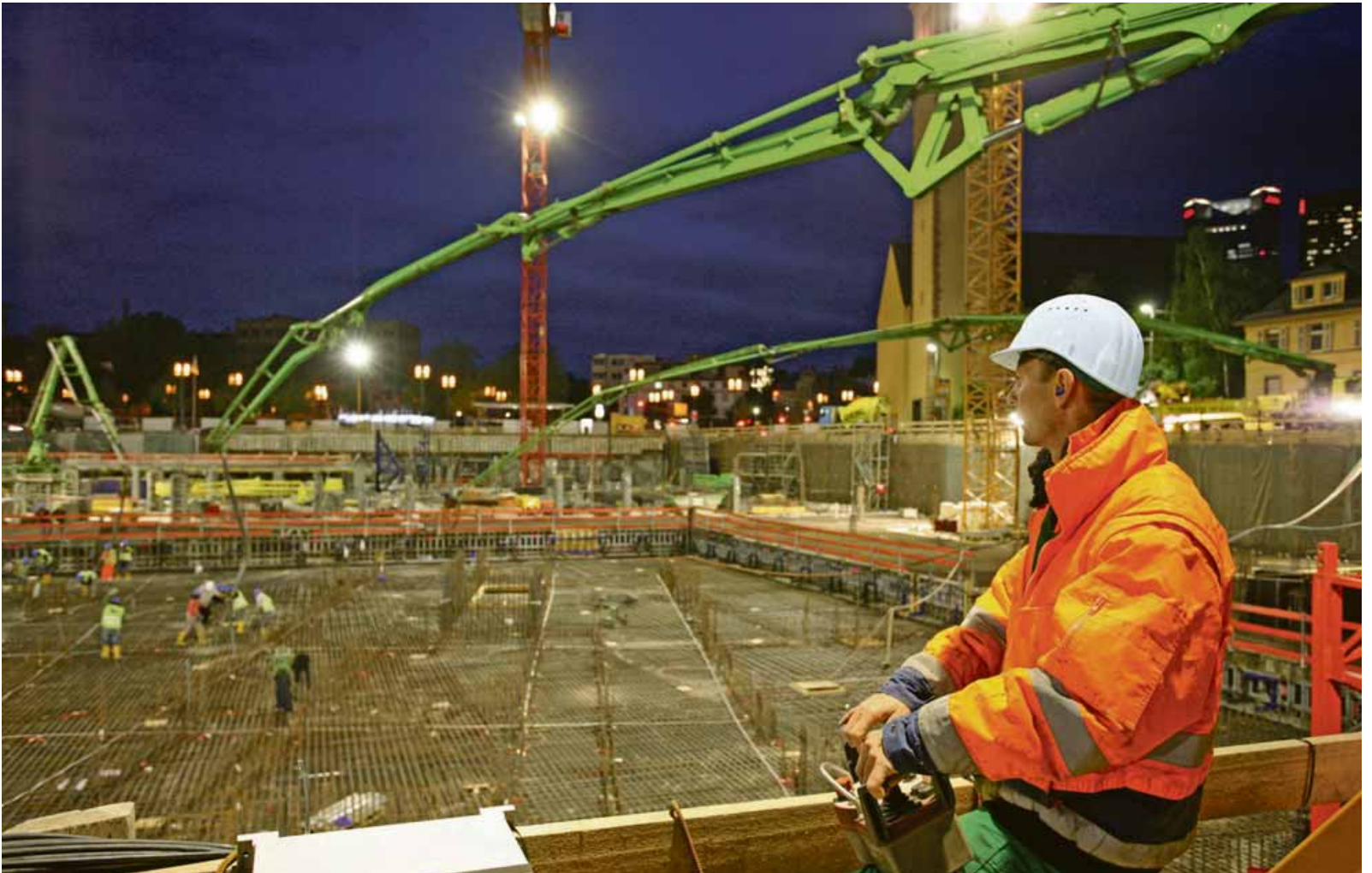
In drei Tagen und zwei Nächten betonieren mehrere Großmast-Autobetonpumpen gleichzeitig die riesige Bodenplatte des Tower 185
