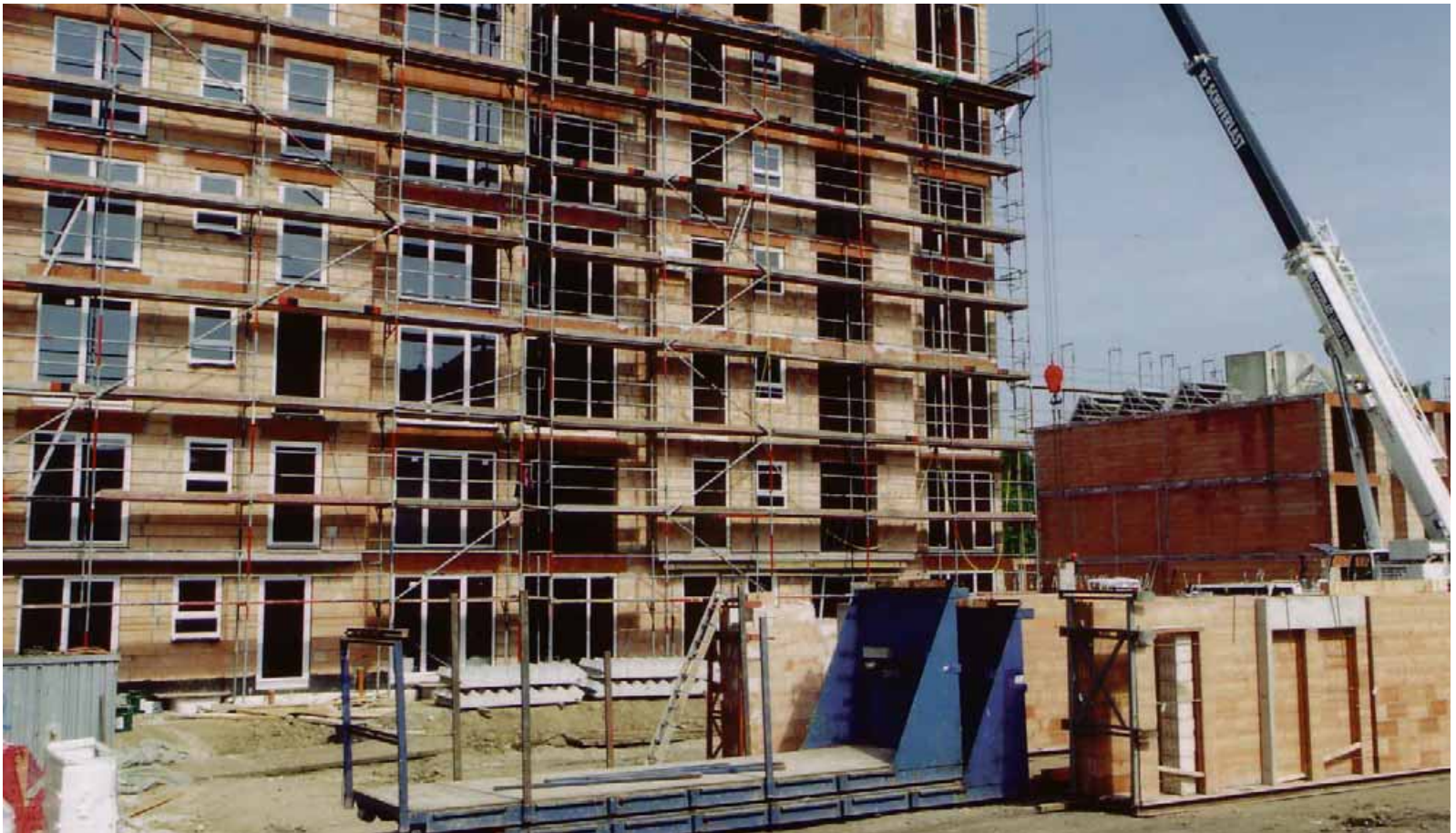
Ersatzneubau statt Sanierung: Mit dem Neubau von mehrgeschossigen Wohneinheiten lassen sich die veränderten Wohnraumsprüche besser befriedigen als mit bloßen Sanierungsmaßnahmen. Foto: UNIPOR, München.
