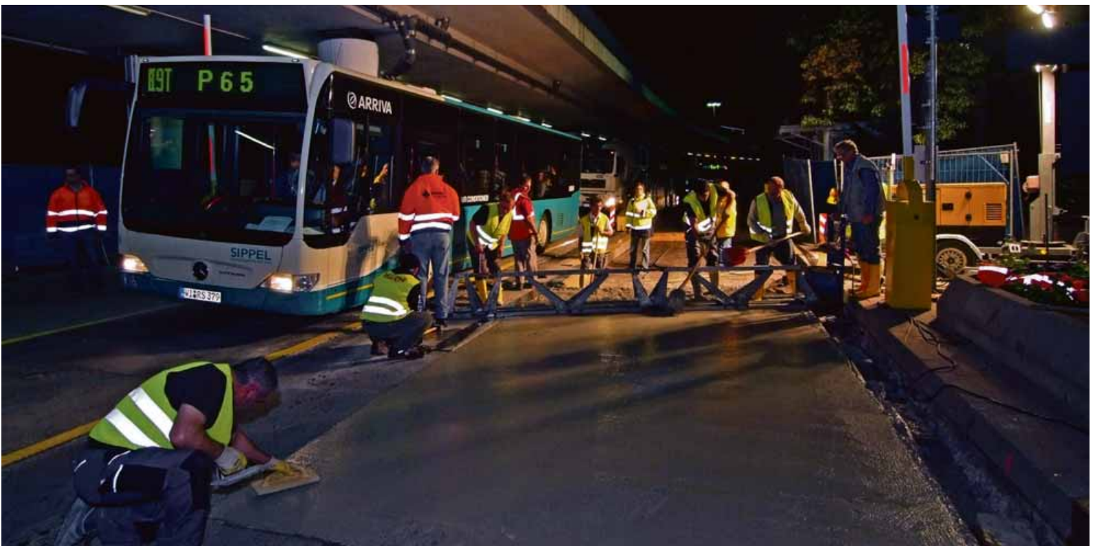
ChronoCem IR beim Einbau am Frankfurter Flughafen: Innerhalb von acht Stunden musste am Terminal 1 ein Teilstück zur Einfahrt zu den Parkhäusern ausgetauscht werden, während auf der benachbarten Fahrbahn Autos und Busse fahren. Foto: HeidelbergCement/Fuchs
