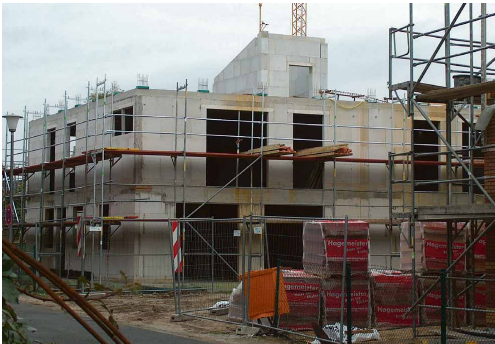
2. Fortschrittlicher Bau: In Münster entsteht bis zum Sommer 2010 eine Wohnanlage im Passivhausstandard mit einem errechneten Jahresbedarf von nur 15 Kilowatt Heizenergie pro Quadratmeter Wohnfläche. Dazu trägt die effektive Isolierung der Außenhülle ganz wesentlich bei. Die Mauer besteht aus einem ortsüblichen Klinker-Verblender sowie dem KS EcoPlus-System aus Hochleistungsdämmung (Polyurethan-Hartschaum) und tragender Innenschale aus Kalksandstein.
